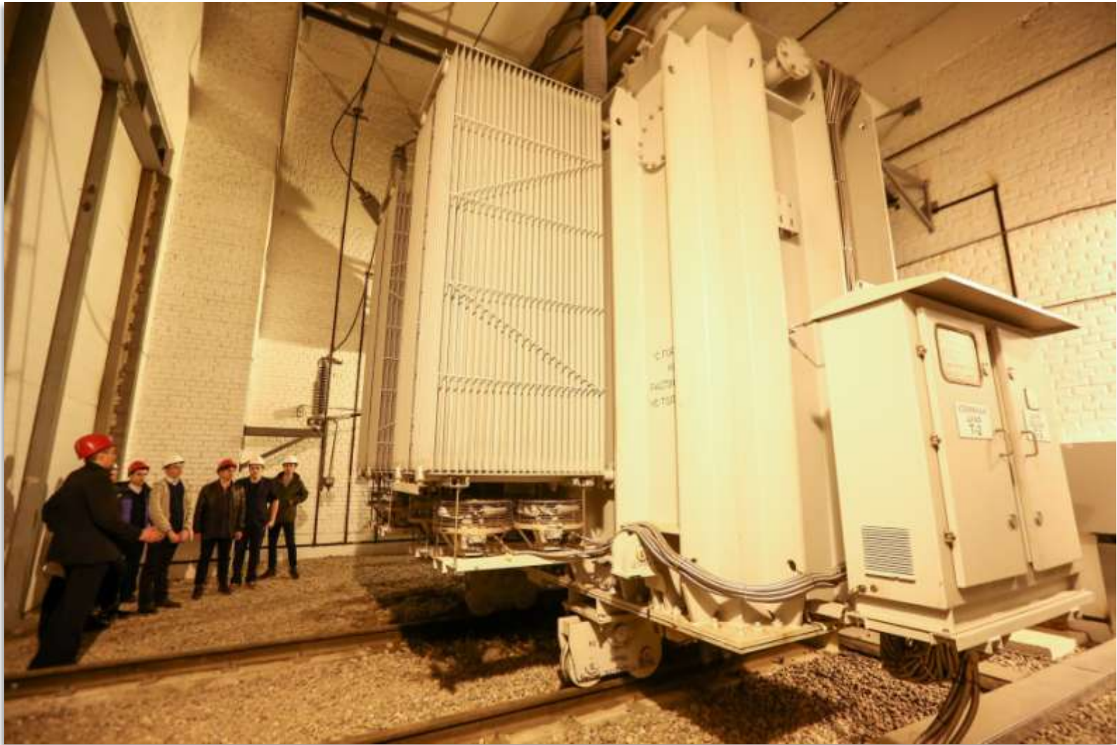
Ленэнерго Подстанция Крестовская
