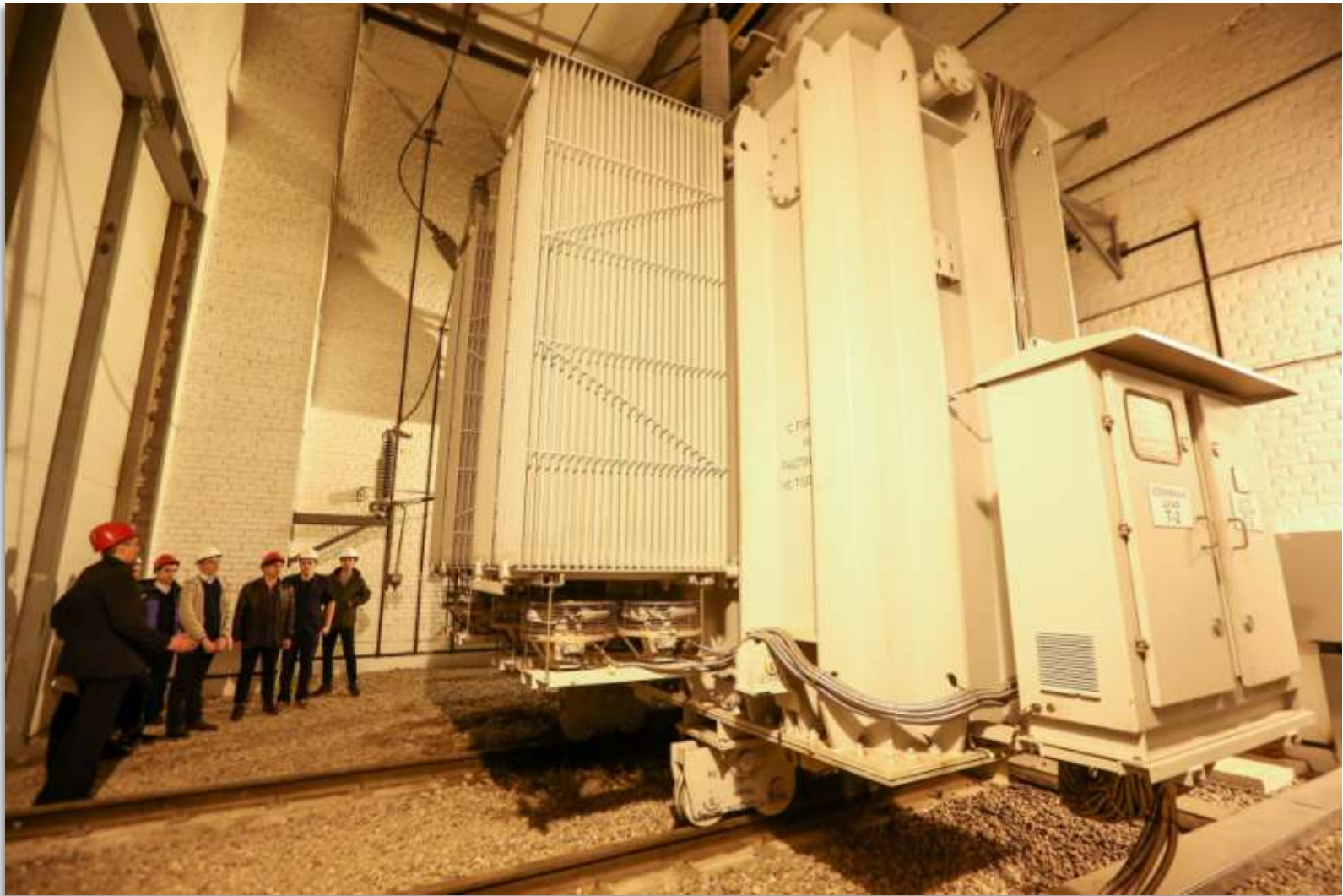
Ленэнерго Подстанция Крестовская
