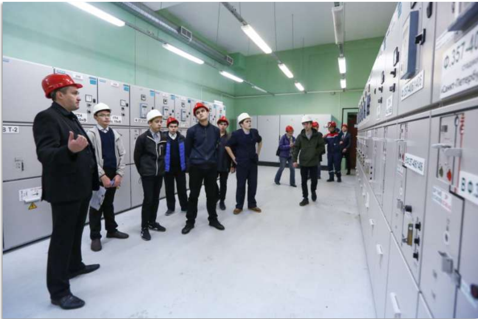
Ленэнерго Подстанция Крестовская
